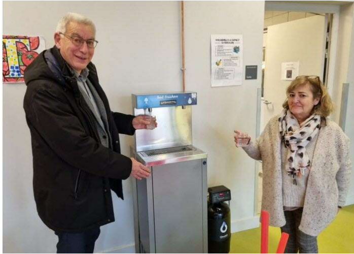
Installations de filtres dans les écoles/crèches de Communay
